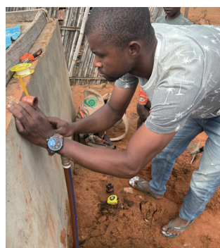
井戸から地下タンクへの配管
